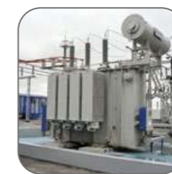
Объекты энергетической отрасли
